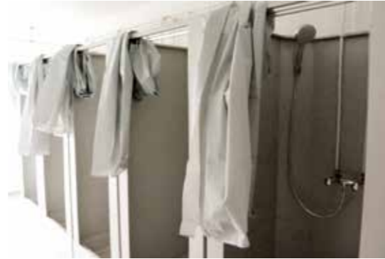
Eines der größten Probleme bei der Schaffung und Ausstattung der Einrichtungen war die Bereitstellung von Duschcontainern. Der Markt war leergefegt. Also wurden ganz normale Container nach eigenen Plänen bedarfsgerecht ausgerüstet. Foto: HEAE/Heldmann
