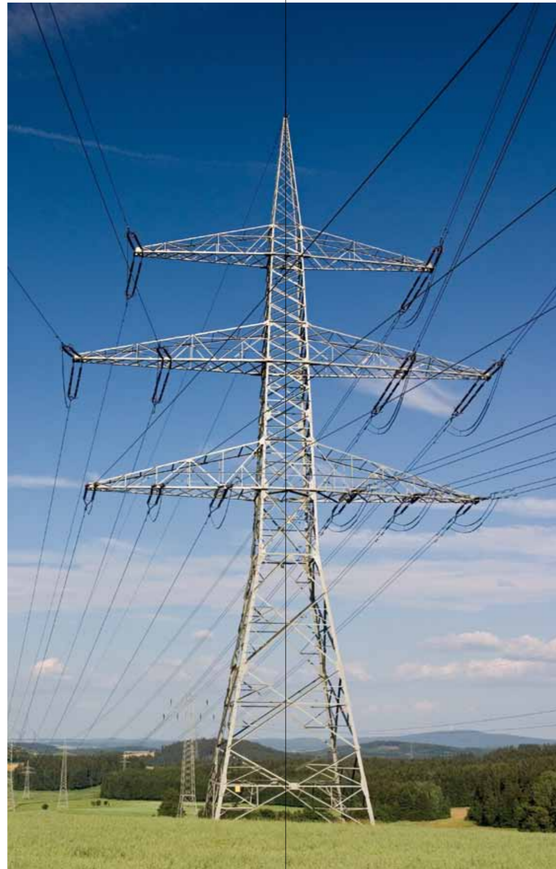
Über Masten wie diese will der niederländische Netzbetreiber TenneT die 380kV-Höchstspannungsleitung vom niedersächsischen Walle nach Mecklar bei Bad Hersfeld führen. Im Raumordnungsverfahren fiel die Entscheidung für die Westtrasse durch die Landkreise Kassel und Schwalm-Eder in den Landkreis Hersfeld-Rotenburg, weil sie dort weitgehend mit bereits vorhandenen Stromleitungen gebündelt werden kann. Im Regierungspräsidium Kassel hofft man, das anschließende Planfeststellungsverfahren noch im Jahr 2012 abschließen zu können. Foto: Reinhard Feldrapp
