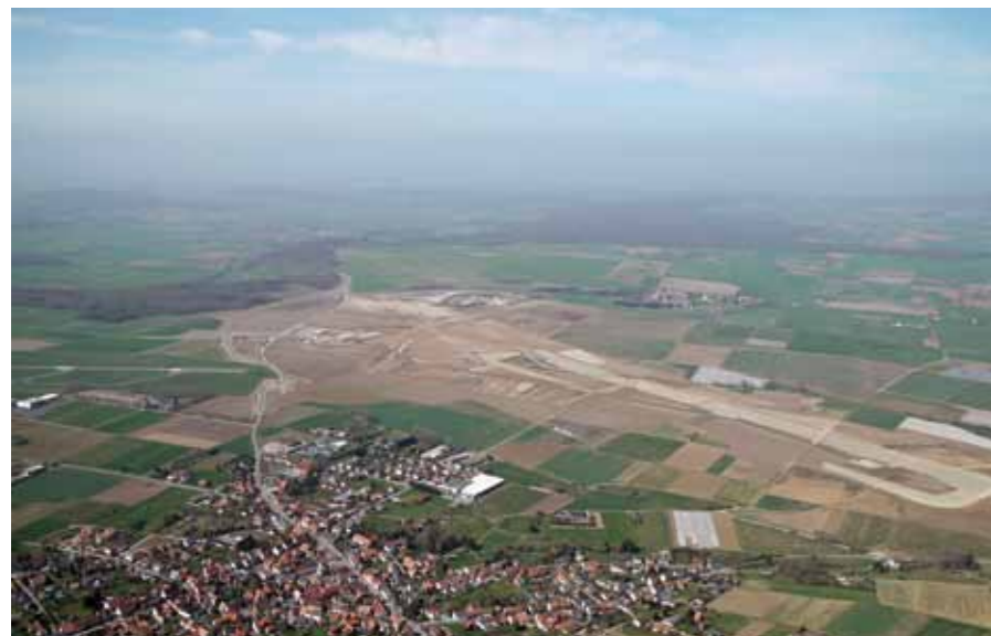
Schon wenige Wochen nach dem Baustart für den Flughafen Kassel-Calden ließen sich aus der Luft in Teilen die künftige Start- und Landebahn und die Rollwege erkennen. Foto: Flughafen GmbH Kassel
